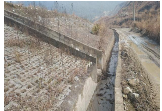
堆场截排水沟
