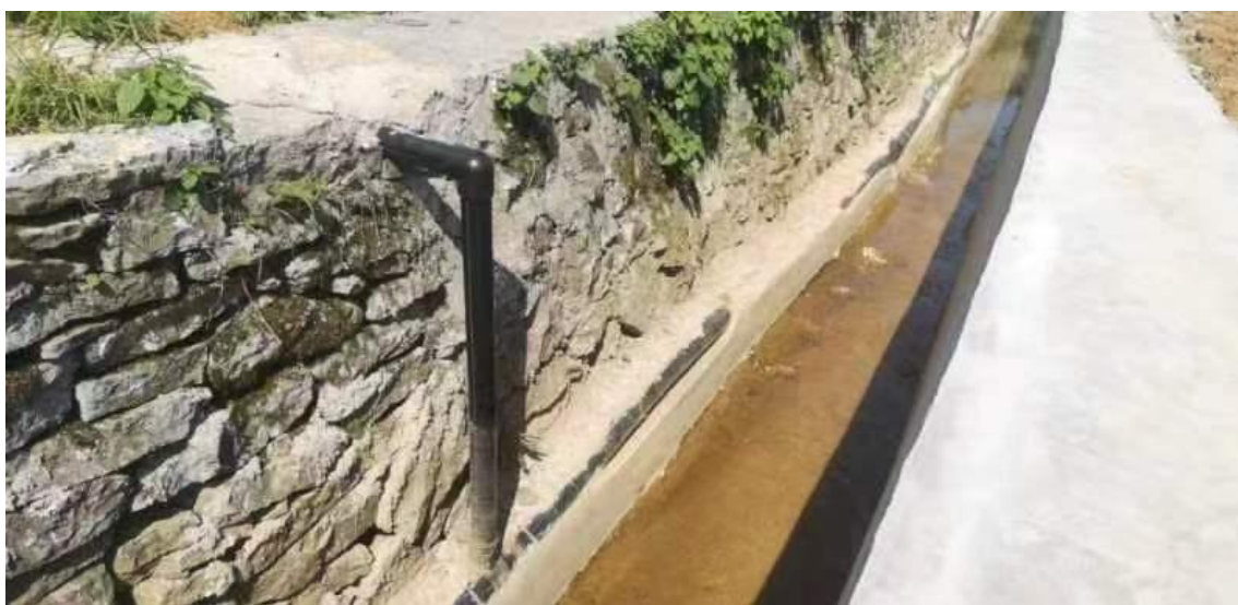
图 3.2-5 部分排渗管照片
