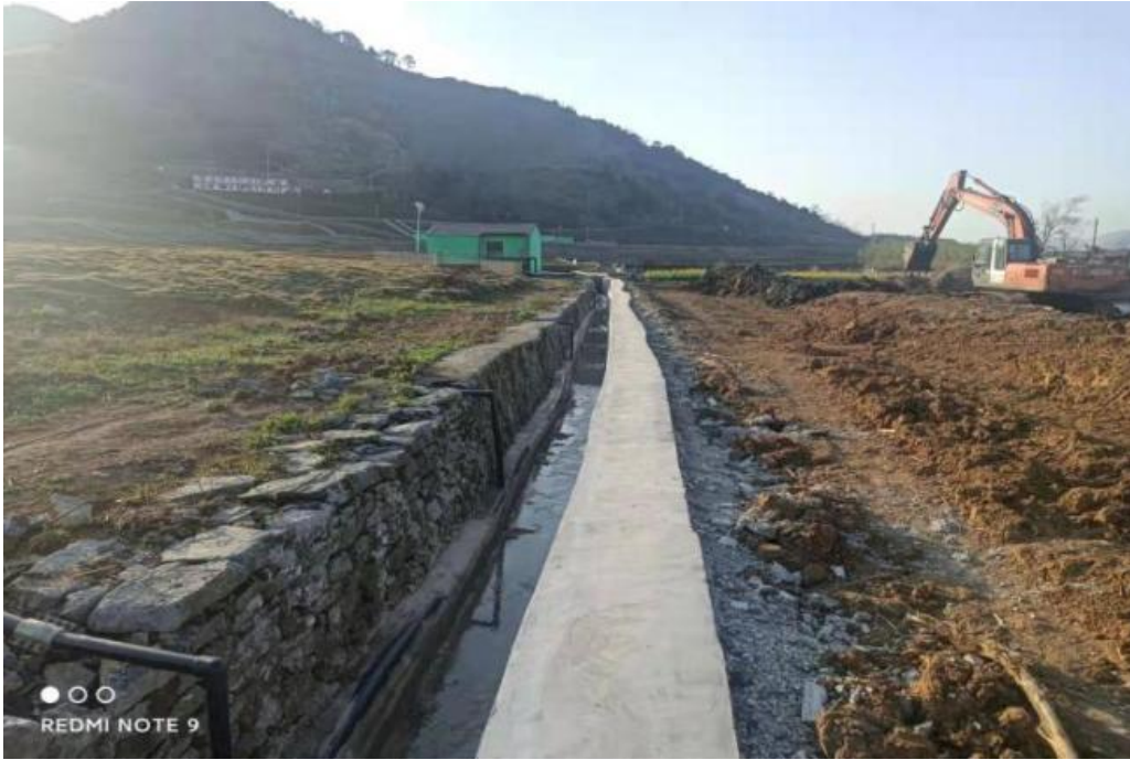
图 3.3-5 尾矿库渗滤收集沟及渗滤液收集管照片
