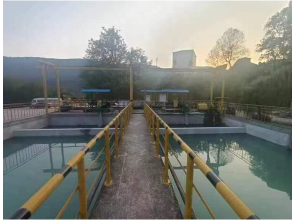
1000m 3 絮凝沉淀池（千吨水池）
